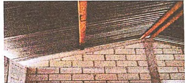
Foto 4: El Centro Educativo se necesita cambios estructuras metalicas
