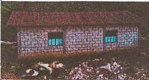
Foto 1: El establecimiento requiere cambios de techos para mejorar la condiciones
